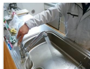
給水流量の確認
