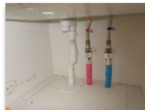
給水管・給湯管
